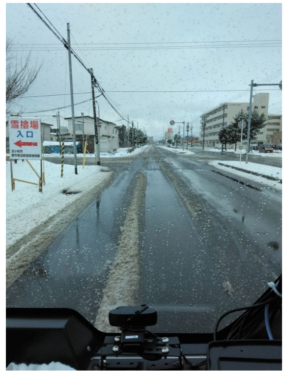
図一24 路面悪化状況
